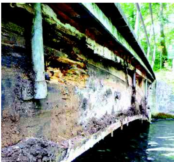
▲ Ansicht auf den stark geschädigten Träger
