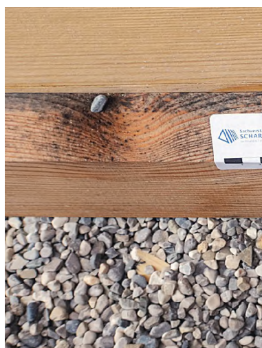
▶ Das Schwellholz mit holzverfärbendem Pilzbefall
