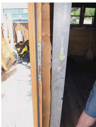
◀ Verworfenener Türausschnitt an der Außenwand
