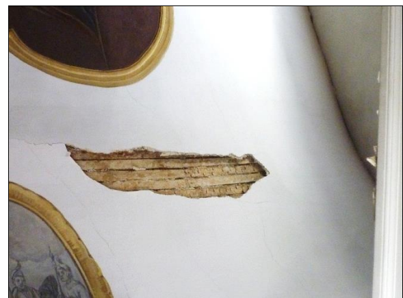
Abbildung 8: Abplatzungen des Putzgewölbes, aus [10]
