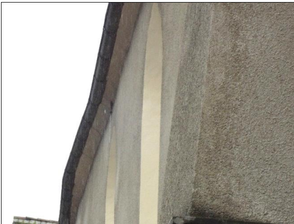
Abbildung 10: Verformungen auf der Nordseite
