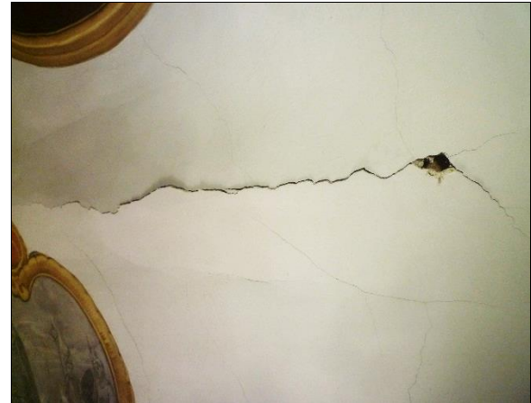
Abbildung 7: Riss in der Gewölbeschale, aus [10]
