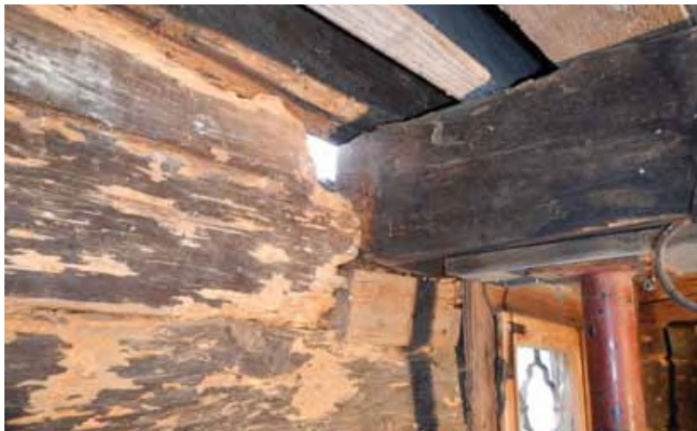
oben: Typisches Schadensbild an der östlichen Blockwand: Fäulnis, Insektenbefall, verdrehte Balken
