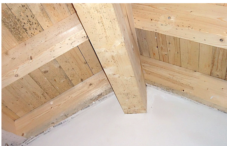
► Befall mit Schimmelpilzen am Dachstuhl
