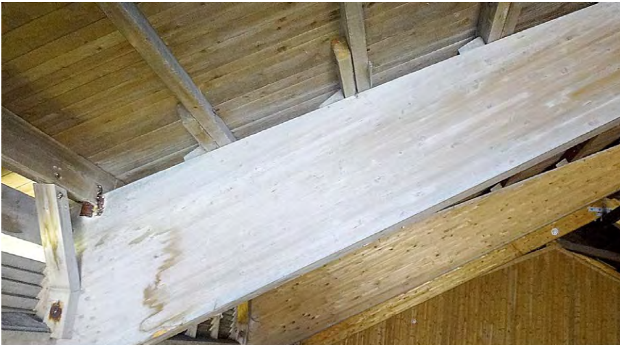
(5) Brettschichholzträger mit Feuchteverfärbungen
