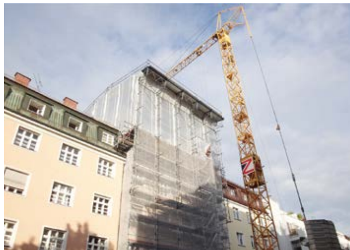
Abb. 2: Ein Wetterschutzdach stellt eine teure aber effiziente, organisatorische Holzschutzmaßnahme dar. Für große Gebäude, die zwangsläufig über längere Zeiträume gebaut werden, ist es aber eine lohnende Investition. Es muss auch nicht immer so aufwändig wie hier sein.
