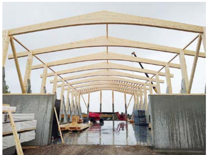
Abb. 1: Wenn Holztragwerke bei ungünstigen Witterungsbedingungen aufgestellt werden müssen, ist eine direkte Bewitterung möglichst kurz zu halten. Insbesondere Hirnholzanschlüsse sind hierbei gesondert zu schützen.
