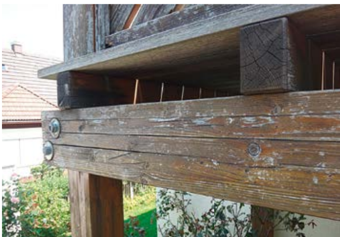
Abb. 6: Hier stimmt so einiges nicht: Alle Bauteile weisen keinen konstruktiven Holzschutz auf. Dies entspricht nicht den entsprechenden Fachregeln des Zimmererhandwerks. Insbesondere die frei bewitterten Hirnholzflächen und Kontenpunkte weisen Schäden auf. Direkt bewitterte Brettschichthölzer wiesen zudem deutliche Delaminierungen (ein Auflösen des Klebverbundes) auf. Ohne konstruktiven Holzschutz entsprechen diese Bauteile heutzutage nicht mehr den anerkannten Regeln der Technik.
