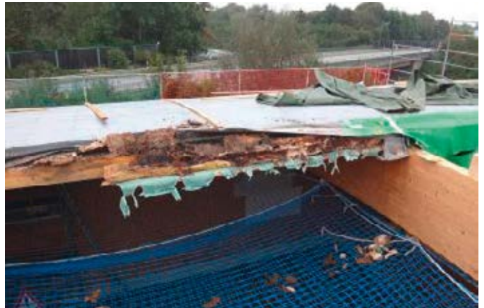
Holzschutz ist immer Feuchteschutz! Mangelhaft geplante und ausgeführte Dachkonstruktion einer Einstellhal-
