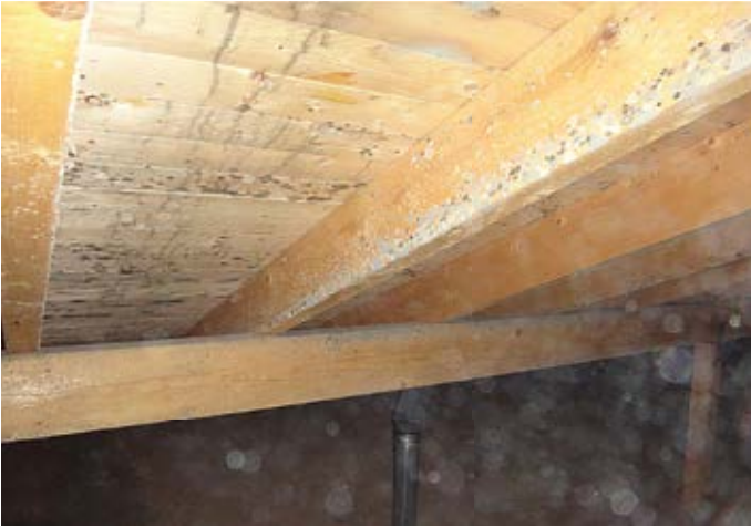
Abb. 4: Befall mit Schimmelpilzen an einem Dachstuhl aufgrund hoher Baufeuchte. Ursächlich hierfür waren Estrich- und Putzarbeiten in den darunterliegenden Geschossen in Kombination mit einer fehlenden (temporären) Abschottung des Dachgeschosses.
