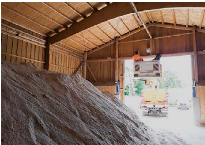
Abb. 7: Insbesondere bei größeren und/oder weitgespannten Holztragwerken ist eine „handnahe“ Überprüfung der Träger, Knotenpunkte und Klebfugen von großer Bedeutung. Nicht selten muss hierfür auf ergänzende Hilfsmittel wie Hubarbeitsbühnen zurückgegriffen werden.
