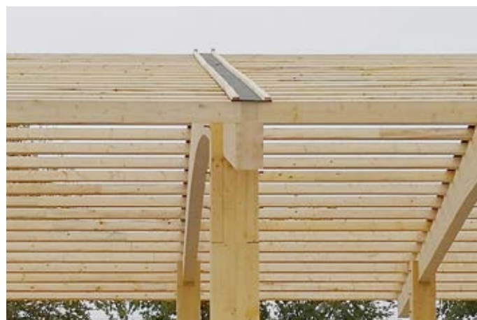
Abb. 3: Eine temporäre Abdeckung des Knotenpunktes Binder-Sparrenpfetten ist eine sinnvolle Maßnahme, die Feuchtebelastung im besonders gefährdeten Hirnholzbereich zu reduzieren.
