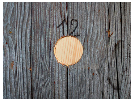
Abb. 6: Nachträglich verschlossenes Bohrloch
